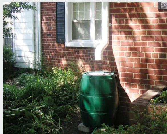
Dispositif de réutilisation des eaux de pluie
